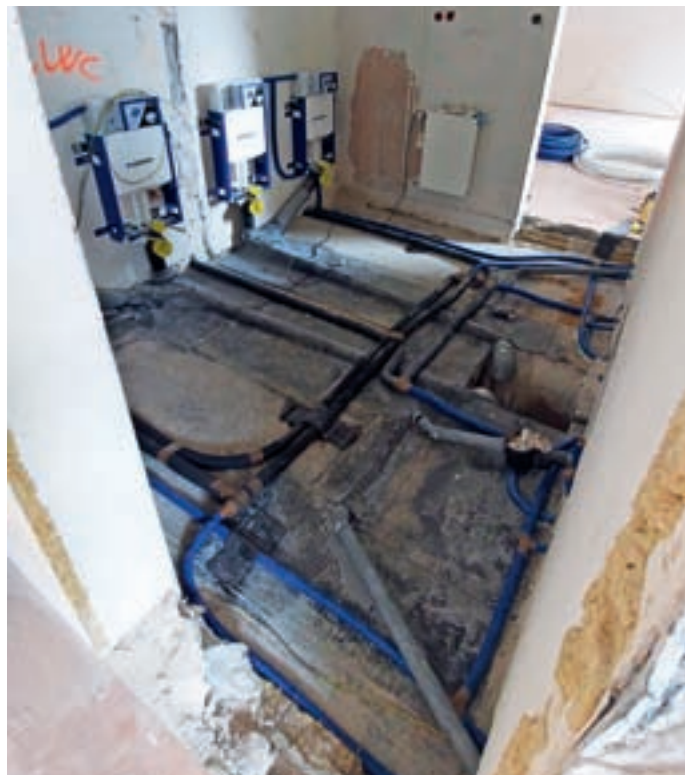
V Vrtcu Zala v Gorenji vasi obnavljajo v lanskih poplavah poškodovane prostore. FOTO: ARHIV OBČINE
